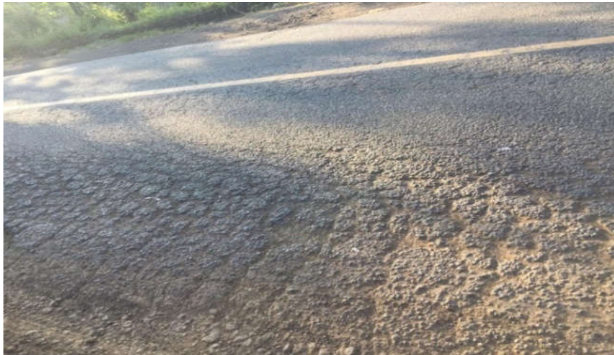
Gambar 1. Kerusakan di lokasi KM 51 Ruas Jalan Nasional Tirtouido
