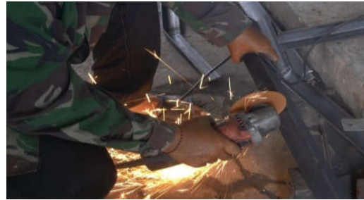
Gambar 3. Pekerjaan Menggerinda Tanpa Menggunakan APD
