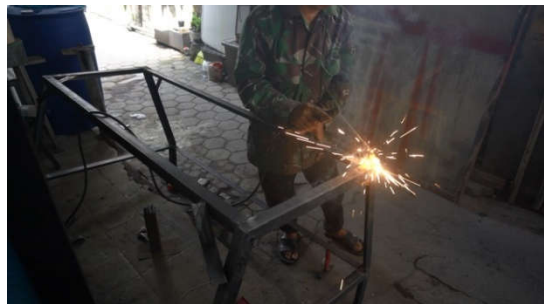
Gambar 4. Pekerjaan Pengelasan Tanpa Menggunakan APD
