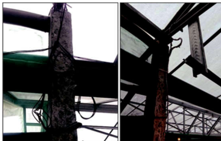
Gambar 7. Kondisi kabel sambungan dan percabangan tanpa isolasi (kiri) dan sesudah direvitalisasi (kanan)
